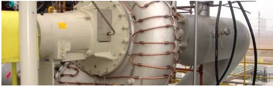
Şekil 219 Buharla Isıl İzleme Tesisat Uygulama Örneği
