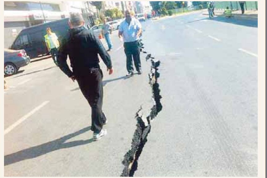
Zübeyde Hanım Caddesi'ndeki çatlak 19 Mayıs'ta görüntülendi.
