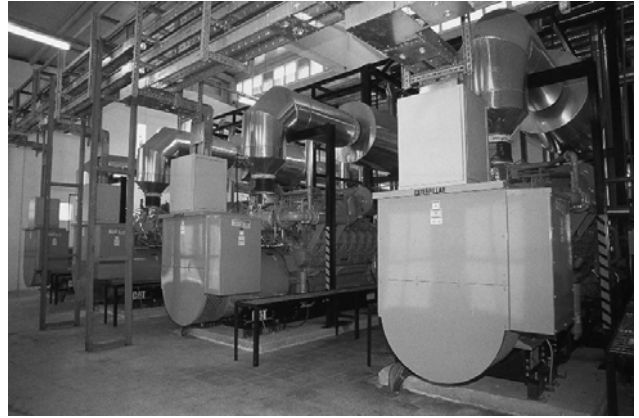
Şekil 4. Kojenerasyon uygulanmış bir tesisin içi
