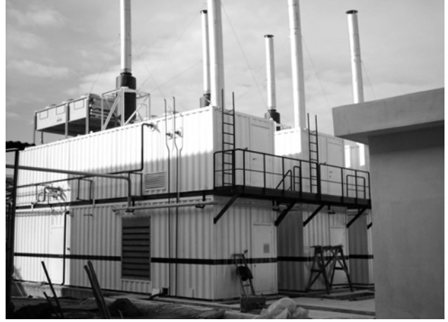
Şekil 3. Kojenerasyon uygulanmış bir tesis
